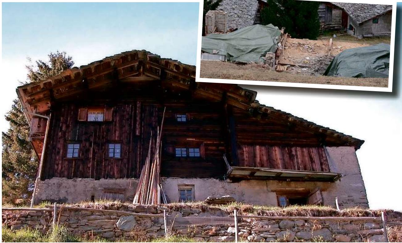
Zerstört: Der Strickbauteil des Hansjörisch Hus in Leis ist bereits abgerissen (kleines Foto).
